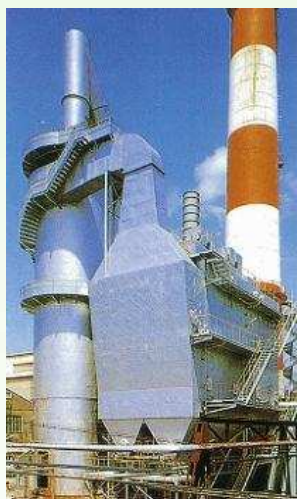
①脱塩・脱硫装置
